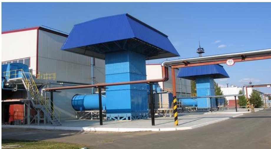
Рис.40. ВОУ Н-100 ГПА-Ц-25 КС «Починки» ООО «Газпром трансгаз Нижний Новгород»
