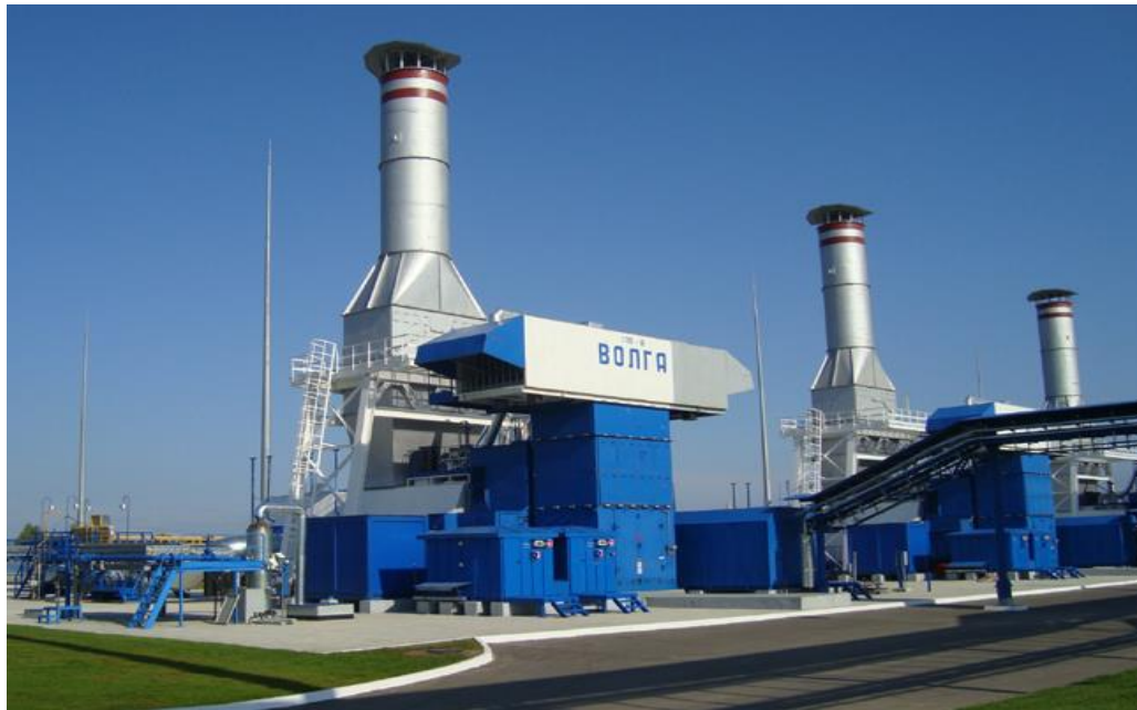
Рис.35. Газоперекачивающий агрегат ГПА-16 «Волга» на КС «Новоарзамасская» ООО «Газпром трансгаз Нижний Новгород»
