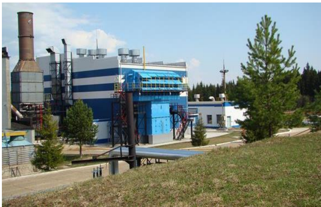
Рис. 36. Газоперекачивающий агрегат ГПА-2,5Р-ПС «Урал» на КС «Игринская» ООО «Газпром трансгаз Чайковский»
